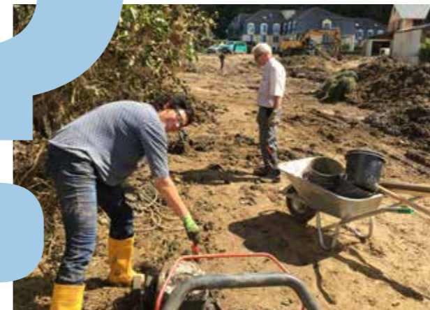
Aufräumarbeiten in Altenburg, Verbandsgemeinde Altenahr
